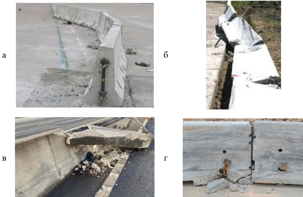
Рисунок Г.7 – Характерные повреждения парапетных ограждений: а – смещение блоков; б – опрокидывание блоков; в – разрушение блоков; г – разрушение анкерных соединений
